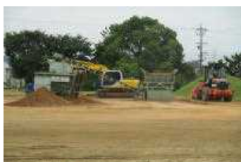
土を再利用するためのプラント
